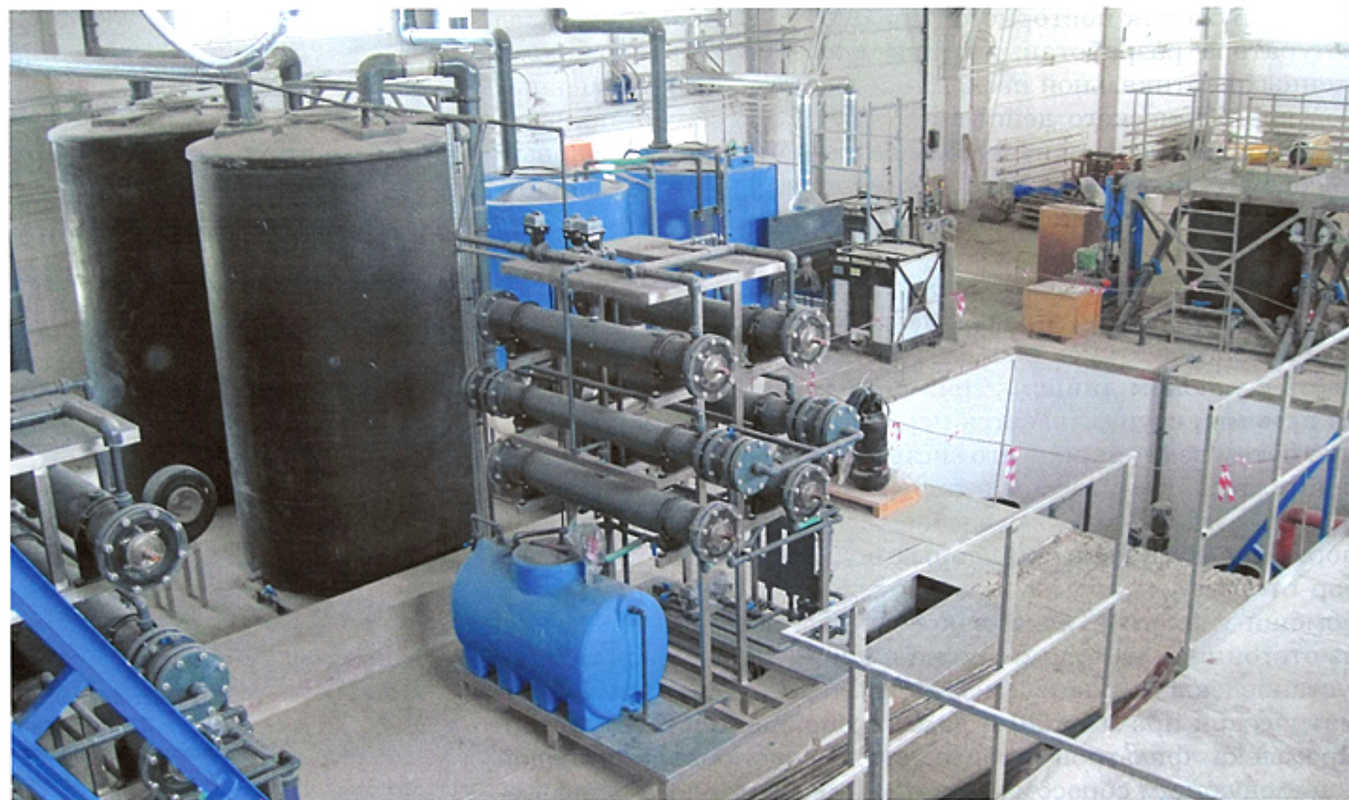
Рис. 8. Две электролизных установки «Хлорэкс» по 500 кг/сут каждая на водозаборе из реки Дон
